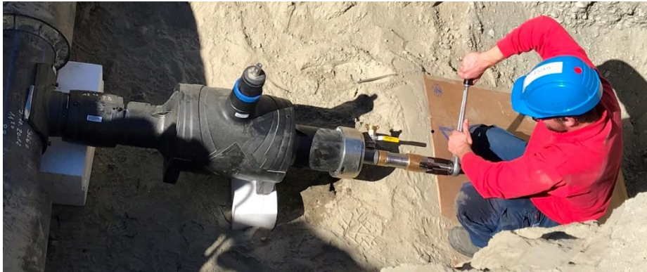
Armatür als Schleuse
