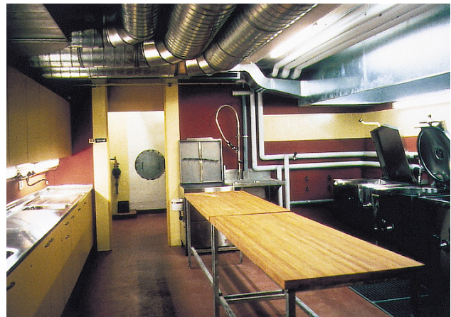
Bild 26 Raumbeleuchtung durch Fluoreszenzlampen
