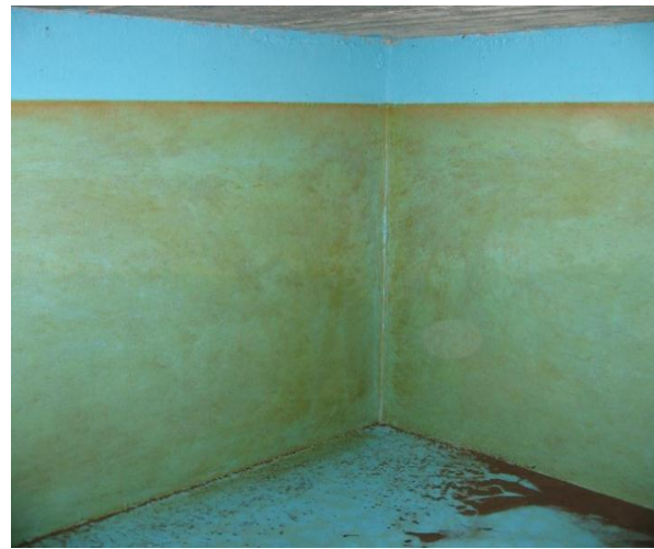
Eisen- und Manganablagerungen
