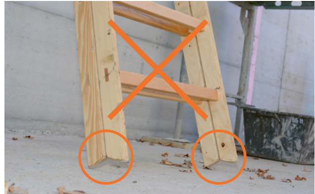
39 Bockleiter als Anstelleiter verwendet – Sie steht nur auf der Kante der Leiterfüsse.
