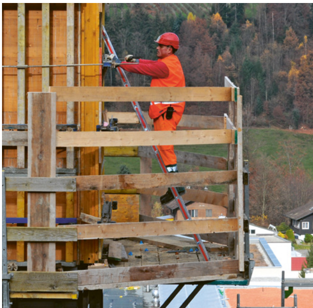
4 Zusätzliche Schutzmassnahme (hoher Seitenschutz) bei erhöhter Absturzstelle
