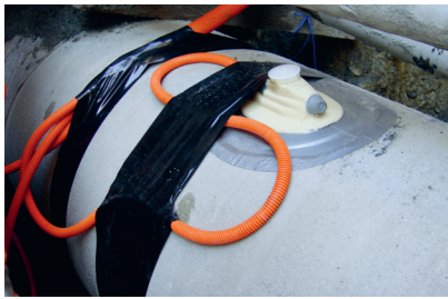
Kabelanschluss an Rohrleitung
