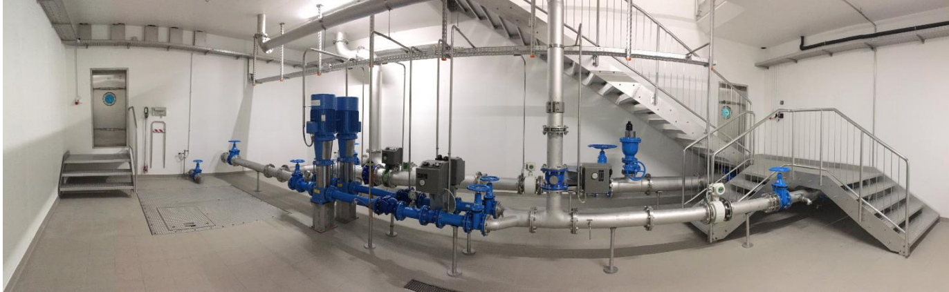
Rohrkeller im neuen Reservoir
