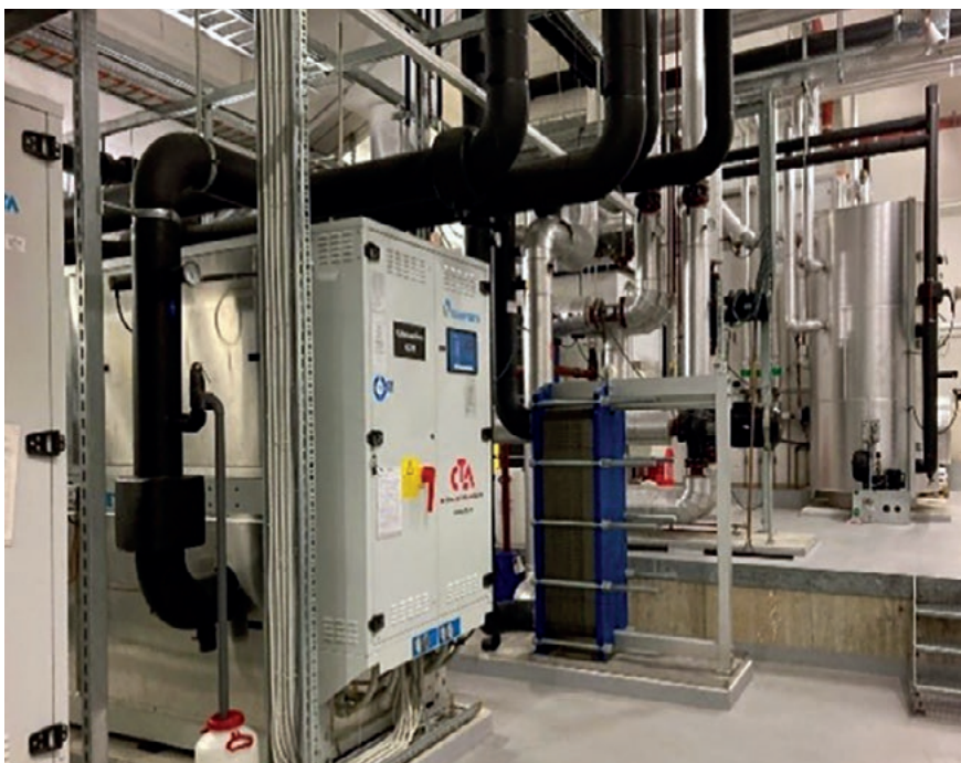
Einblick in die Technikanlagen des Wankdorf-YB-Stadion
